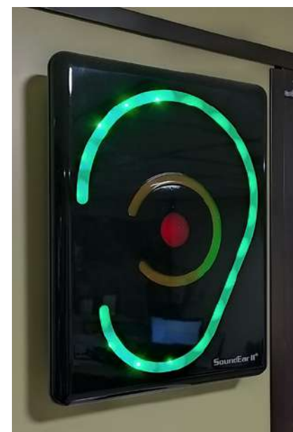
Detector de ruido en el Hospital de Barcelona
